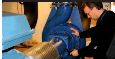
En pump som används till kylanläggningen kontrolleras av Mark Westberg.
